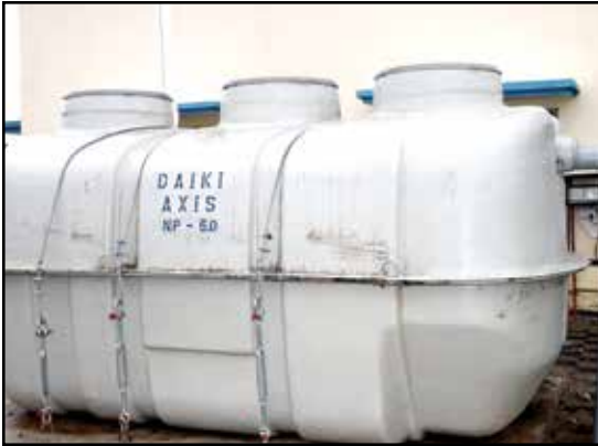
एस.टि.पि. मेसिन रंगेली नगरपालिका, रंगेली अस्पताल र ७ नं. वडा कार्यालय
